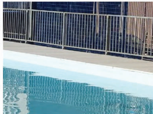
Garde corp en métal
